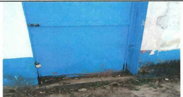
Foto 4: Sustrucción de Puerta
